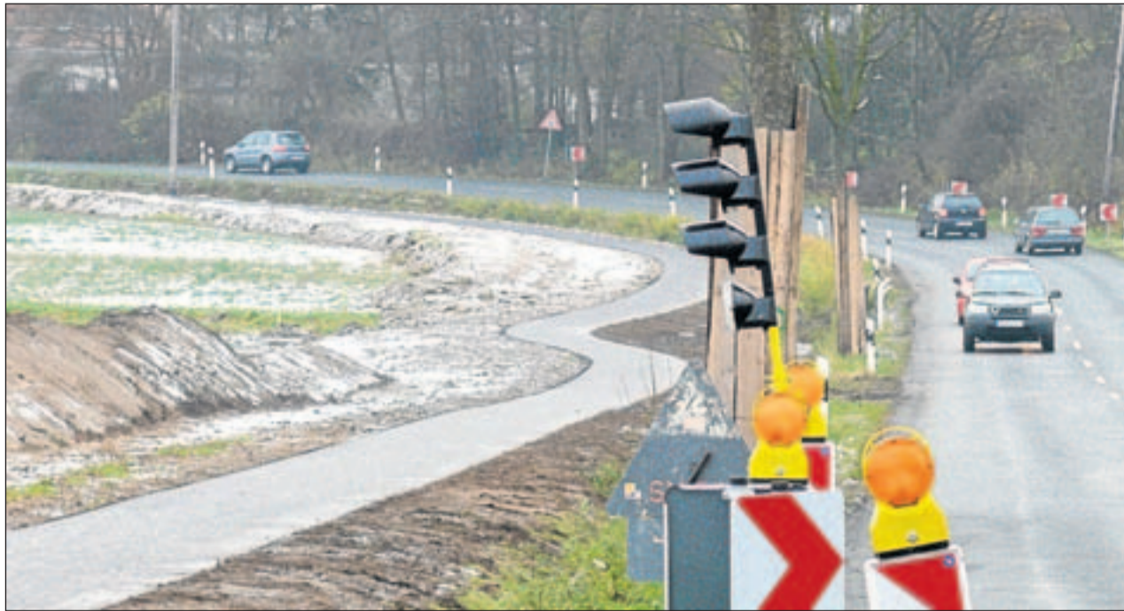
Eine Woche alt ist dieses Foto mit dem neuen Radweg zwischen Volkmarode und Schapen, der ab heute genutzt werden darf. Rechts die Hordorfer Straße, die noch eine neue Decke erhalten wird. Foto: Karsten Mentasti
